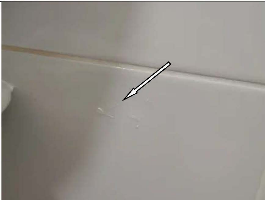
Фото №26. Загрязнение настенной керамической плитки в ванной комнате квартиры.
