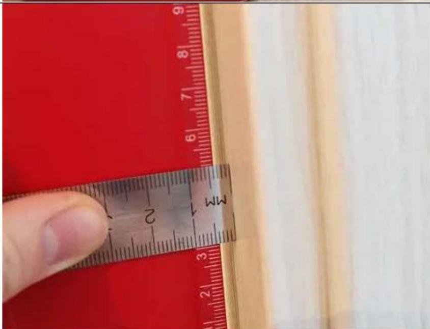
Фото №14. Отклонение наличников санузла в квартире.
