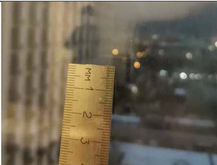
Фото №55. Царапина на стеклопакете оконного блока гостиной в квартире.
