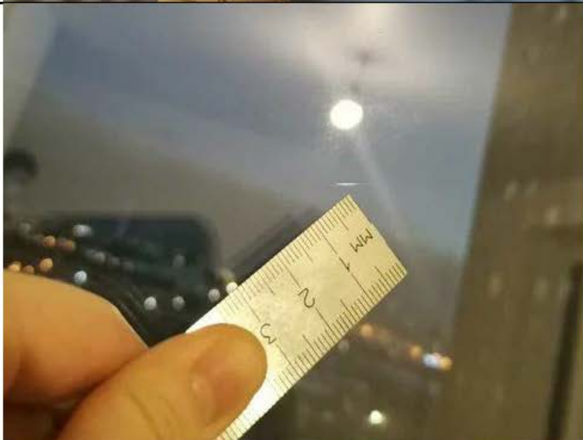
Фото №56. Царапина на стеклопакете оконного блока спальни в квартире.
