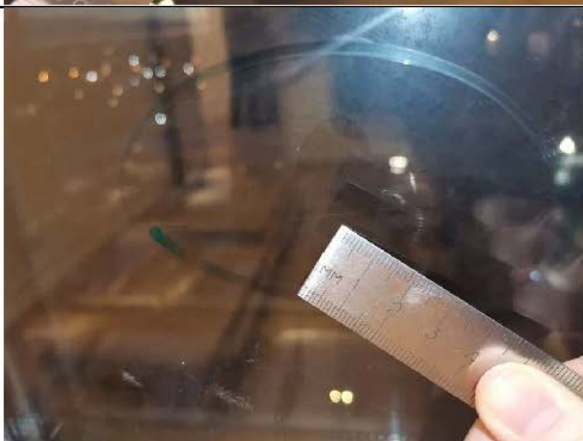
Фото №59. Царапина на стеклопакете оконного блока детской в квартире.
