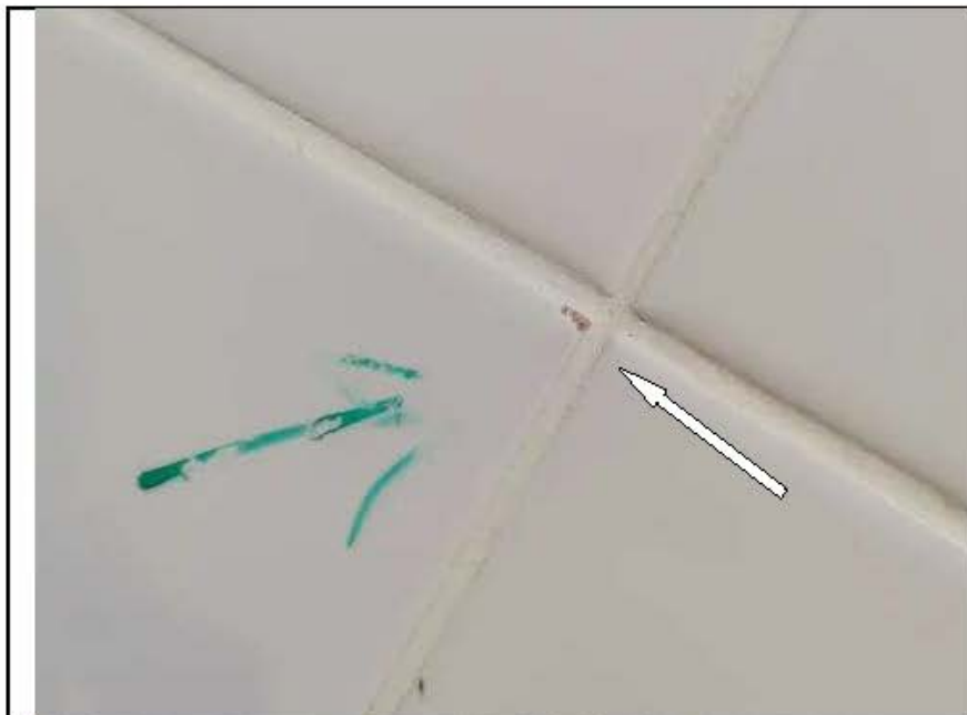
Фото №22. Скол настенной плитки санузла в квартире.
