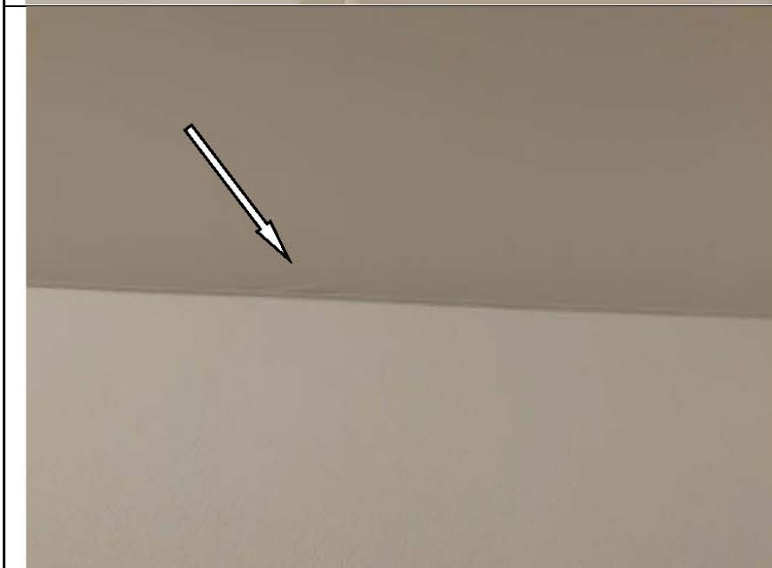
Фото №36. Дефект натяжного потолка на кухне в квартире.
