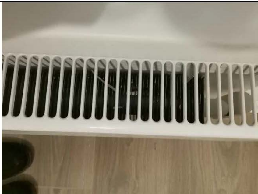
Фото №40. Загрязнение радиатора гостиной в квартире.
