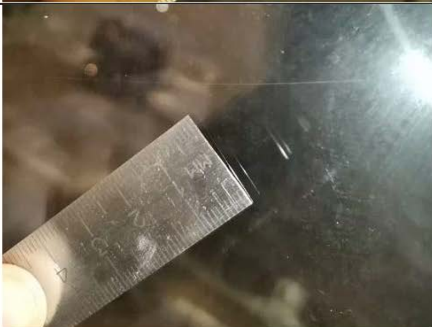
Фото №57. Царапина на стеклопакете оконного блока спальни в квартире.
