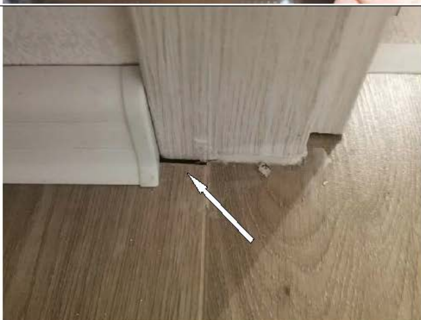
Фото №60. Отсутствует часть ламината на стыке с наличником дверного блока в коридоре.
