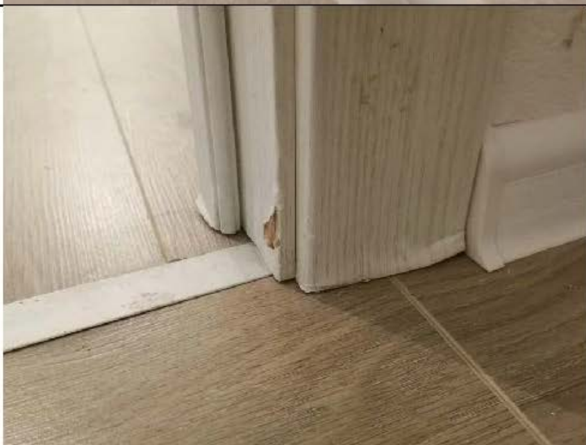
Фото №30. Дефект наличника дверного блока спальни в квартире.
