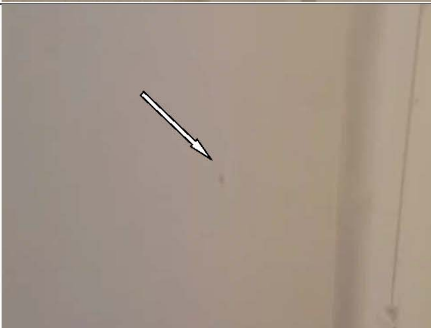
Фото №45. Дефект окрашенного откоса оконного блока на кухне квартиры.
