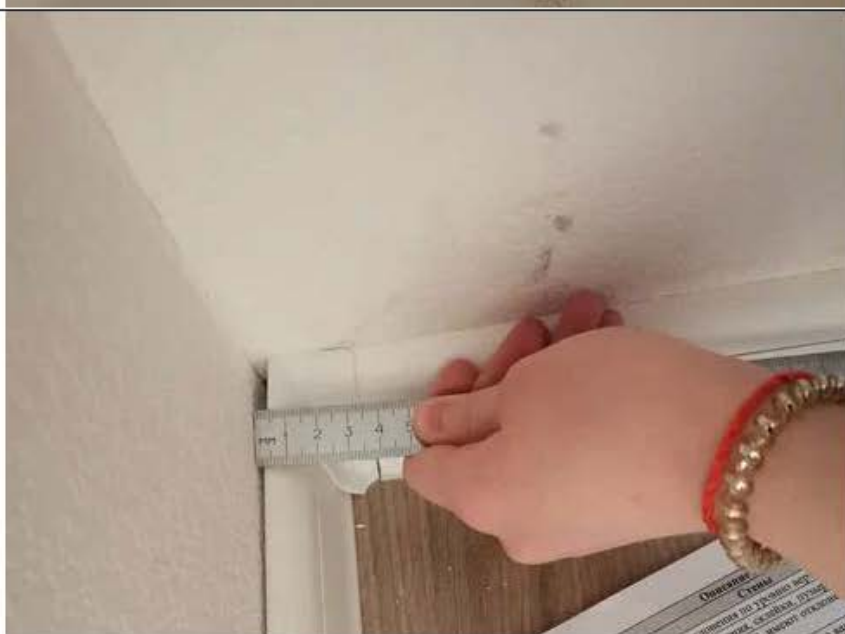
Фото №53. Неплотное прилегание напольного плинтуса ПВХ к стене коридора в квартире.
