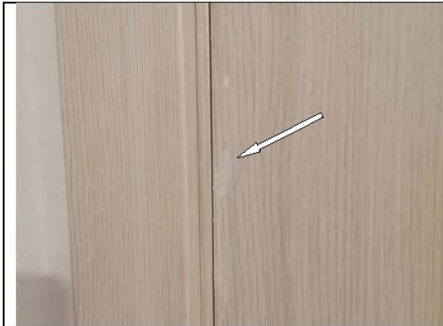
Фото №31. Дефекты дверного полотна кухни в квартире.
