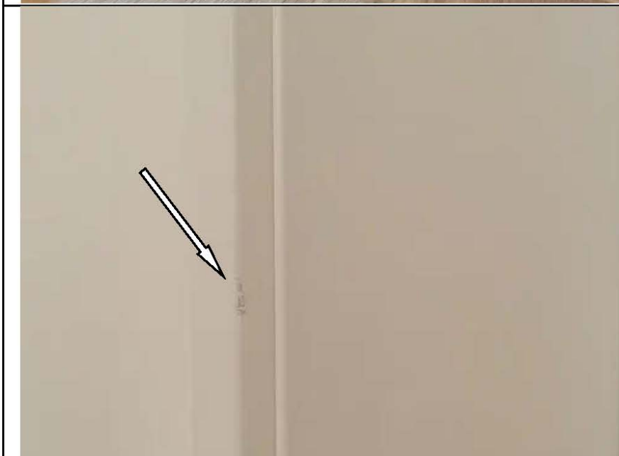
Фото №35. Дефекты дверного блока входной двери в квартире.
