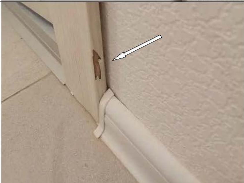
Фото №29. Дефект наличника дверного блока санузла в квартире.
