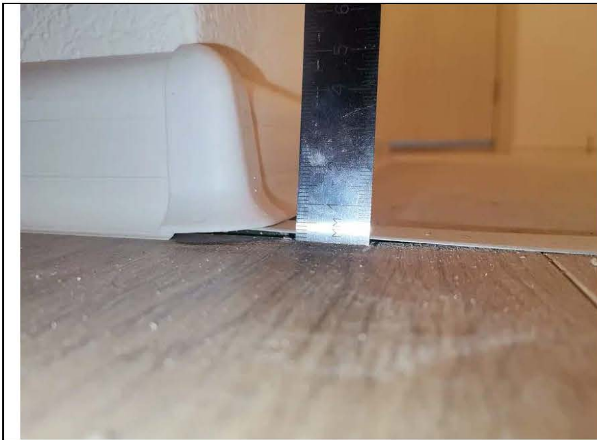
Фото №67. Уступ керамической плитки холла в квартире.
