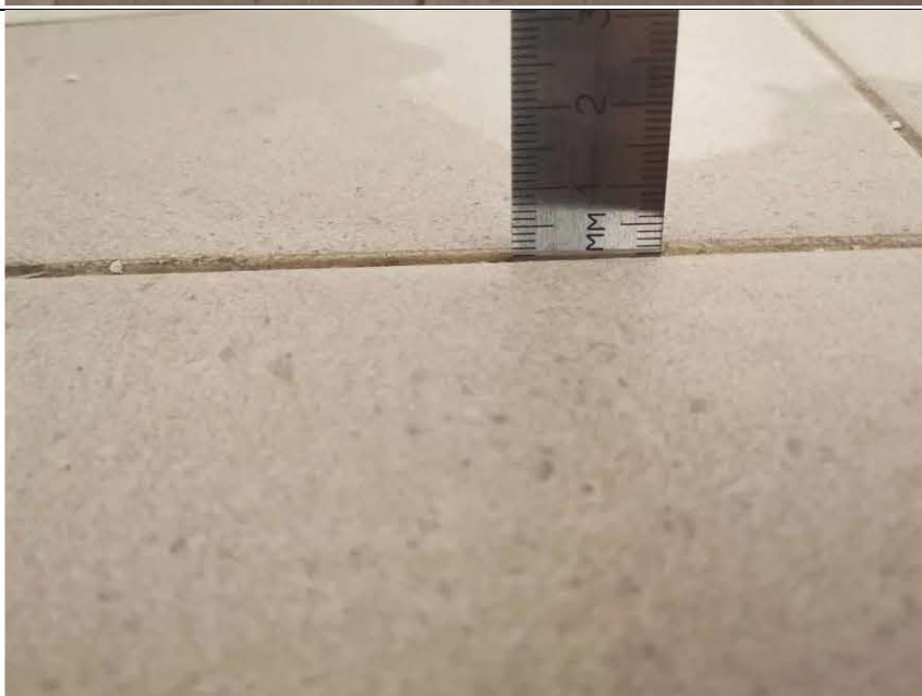
Фото №66. Неполное заполнение шва напольной керамической плитки кухни в квартире.
