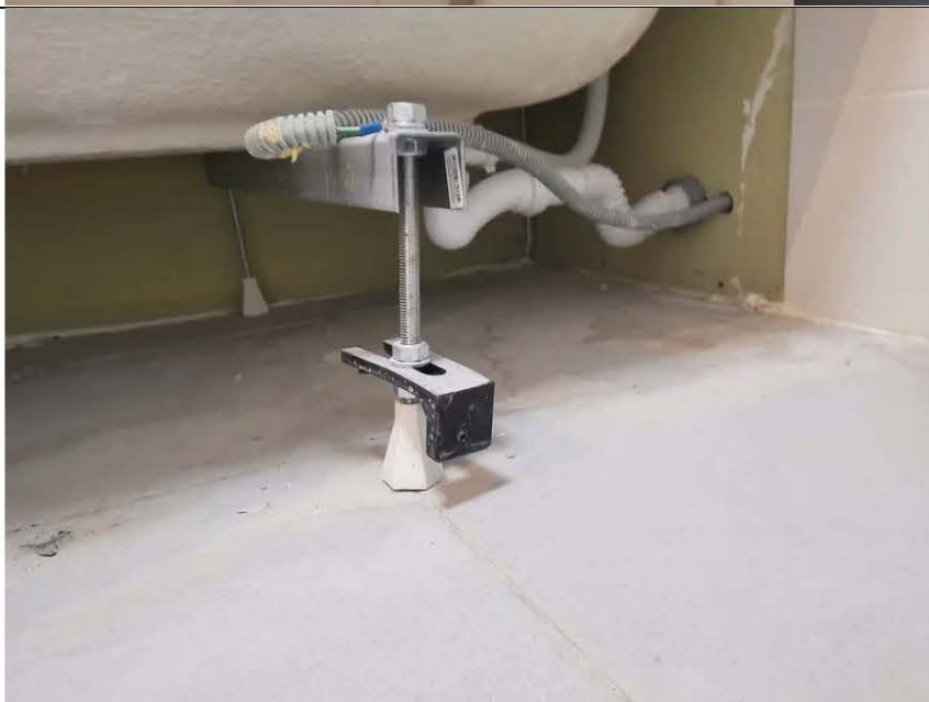
Фото №63. Частично отсутствует настенная керамическая плитка в ванной комнате квартиры.
