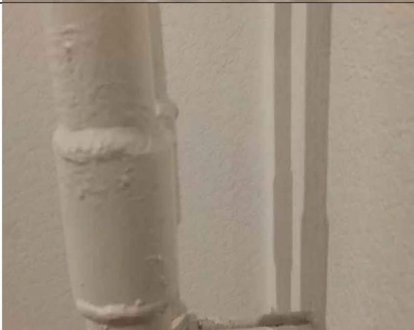
Фото №42. Дефект окрашивания труб отопления в гостиной квартиры.
