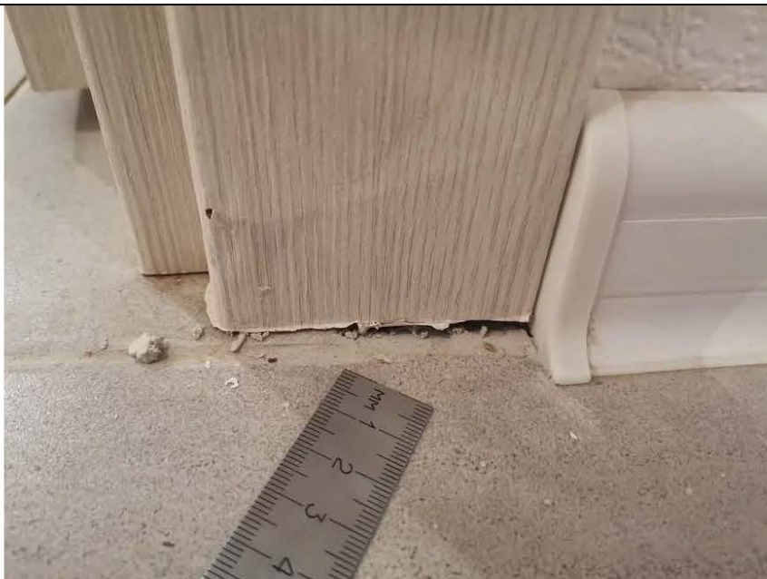
Фото №64. Коротко подрезан наличник дверного блока кухни в квартире.
