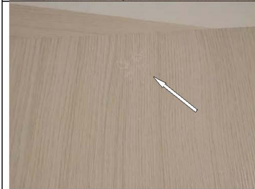
Фото №32. Дефекты дверного полотна кухни в квартире.
