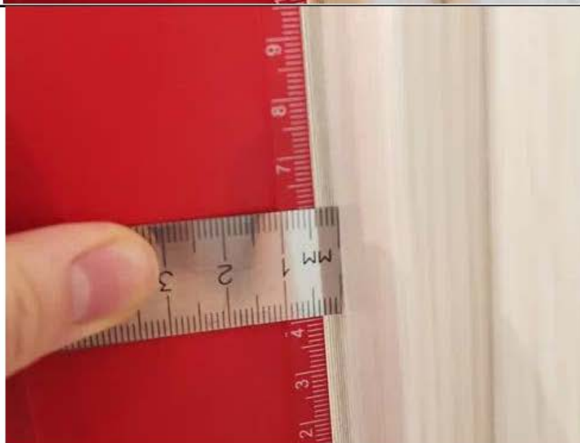
Фото №15. Отклонение наличников кухни в квартире.
