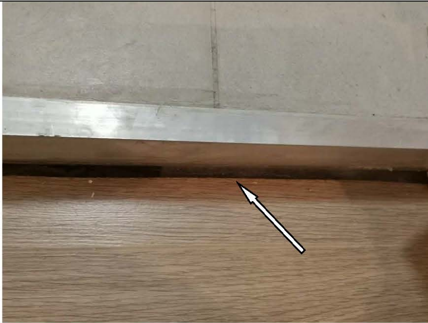
Фото №61. Отсутствует часть ламината на стыке с порогом дверного блока в коридоре.
