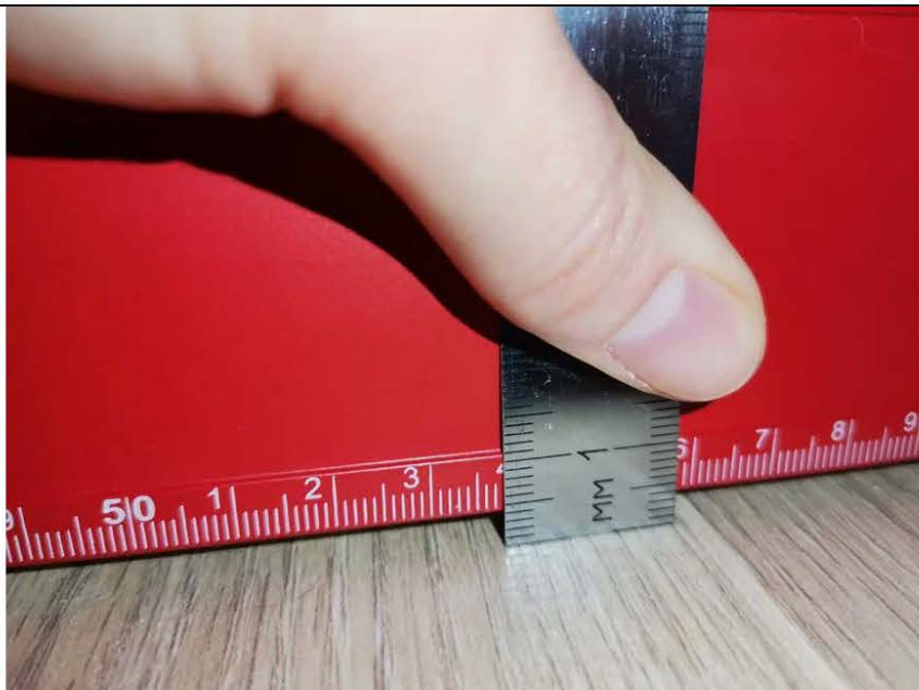
Фото №19. Измерение уровня ламината пола гостиной в квартире.
