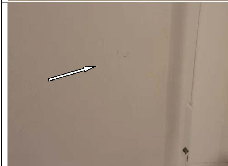
Фото №50. Дефект окрашенного откоса оконного блока в детской квартиры.
