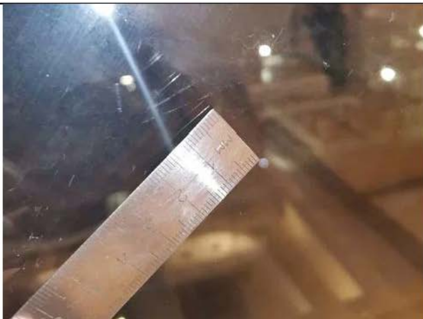
Фото №58. Царапина на стеклопакете оконного блока детской в квартире.
