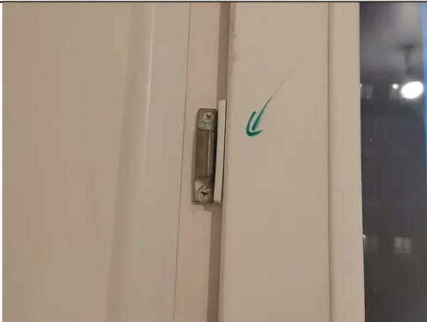
Фото №62. Дефект петли оконного блока детской в квартире.
