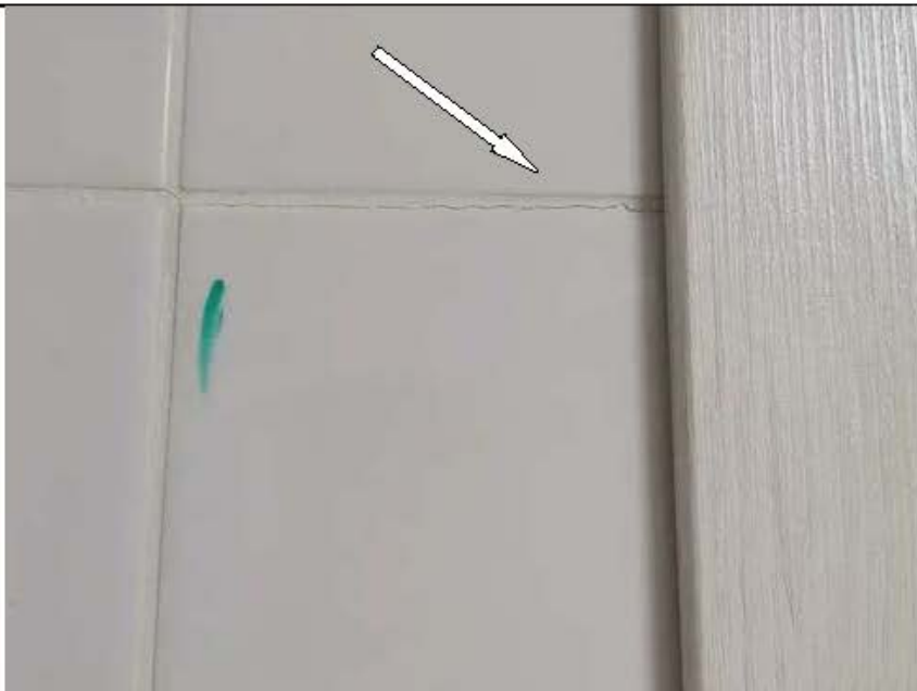
Фото №28. Трещина шва настенной керамической плитки ванной комнаты в квартире.
