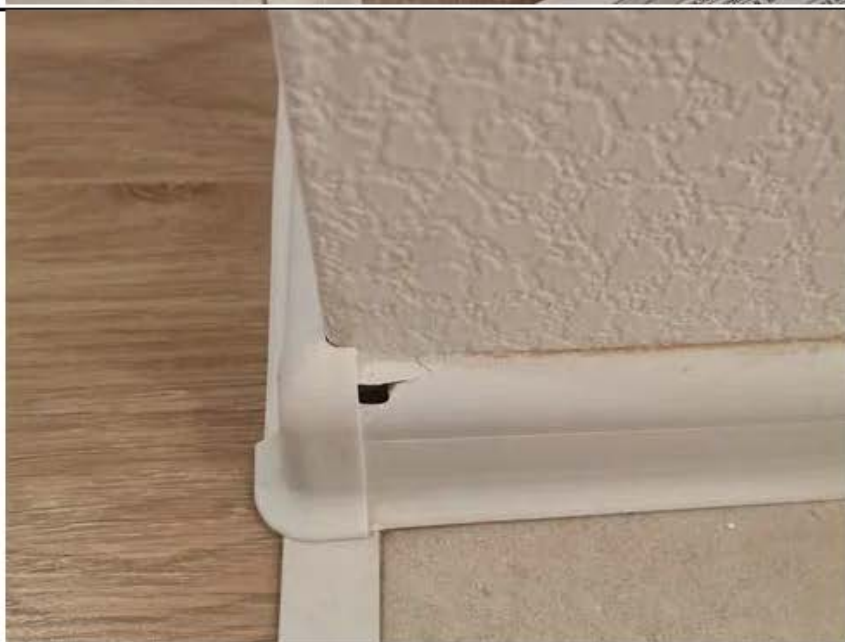
Фото №54. Скол напольного плинтуса ПВХ холла в квартире.
