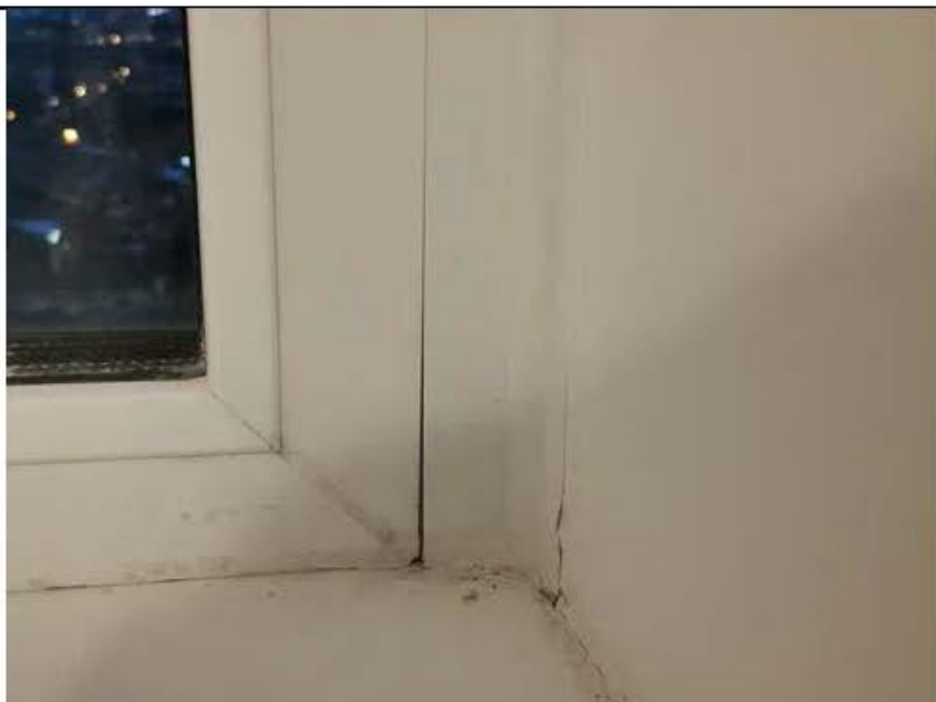
Фото №52. Дефекты профиля ПВХ и щели в оконном блоке в спальне квартиры.
